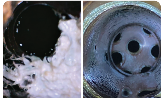
Tubos del intercambiador de calor antes y después del uso continuado del generador de nanoburbujas.
