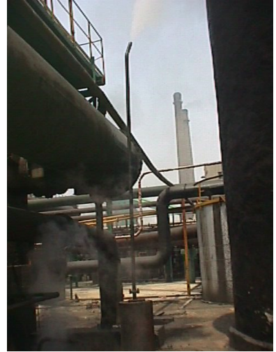
右图为改造前的凝结水闪蒸汽直排
