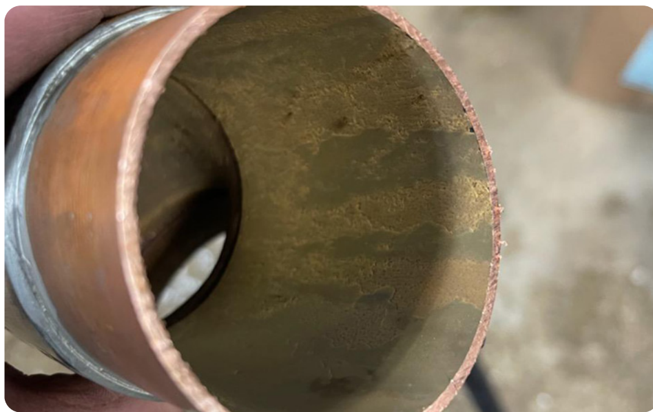
Élimination du tartre par nanobulles sur un échantillon de tuyauterie du système d'eau chaude sanitaire du Memorial Healthcare.
