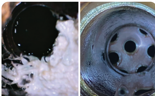
Tubos do trocador de calor antes e depois do uso contínuo do gerador de nanobolhas.
